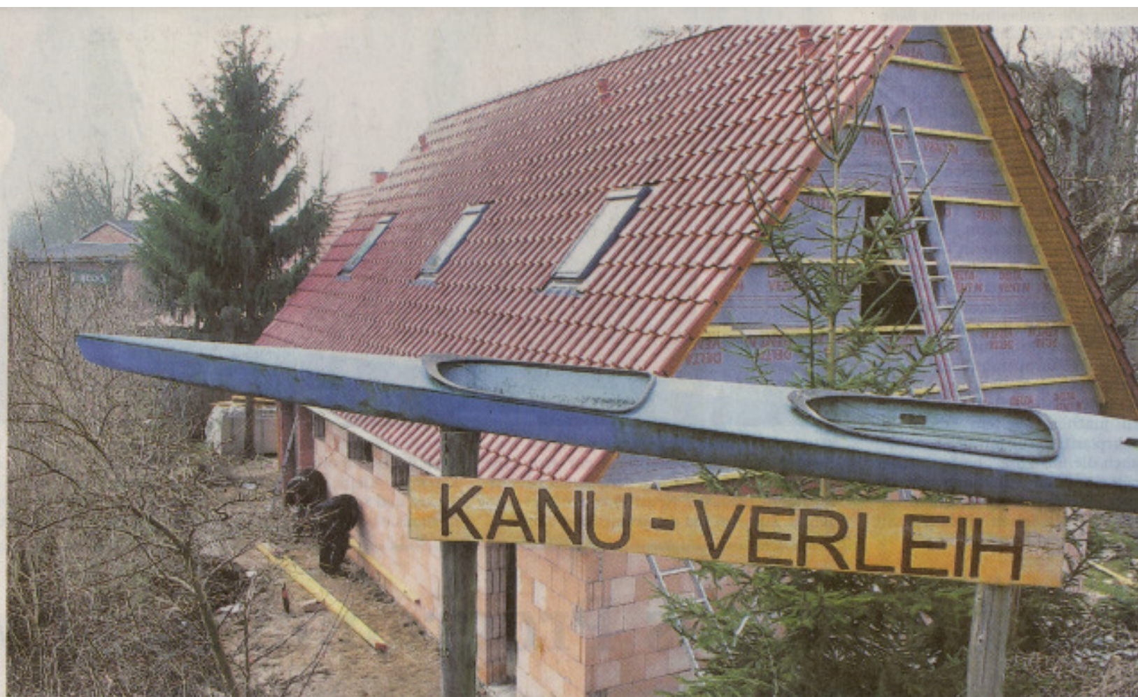
Der Rohbau des neuen Sanitärhauses ist so gut wie fertig. Bis Ende Mai soll auch die Sauna in dem Gebäude betriebsbereit sein. Damit ist die Kanu-
