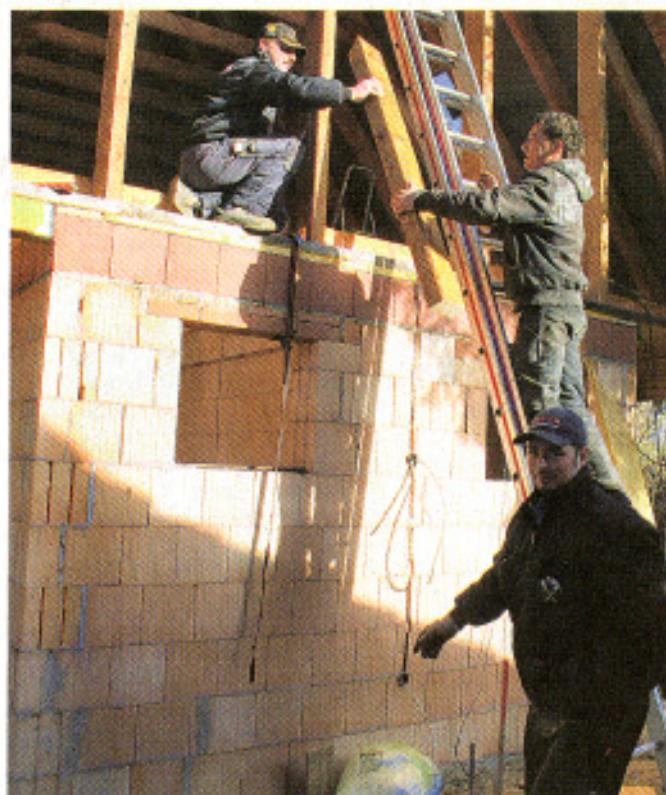
Die Mannen der Dachdeckerei Krumm bauen ebenfalls am neuen Sanitärgebäude der Kanumühle mit. Foto: Dana Seiler
